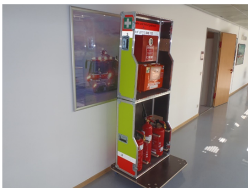
Abb. 9: Emergency Case im Nutzungszustand
